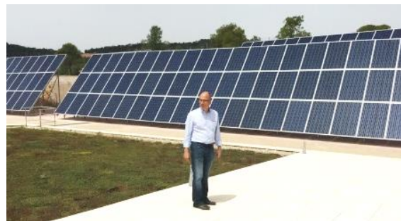
(写真) ボデガに設置されている太陽光パネル。
